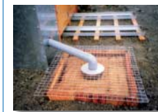
中岳避難小屋 浄化槽
